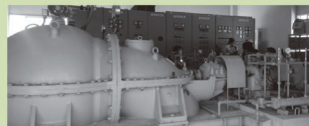
【西岡沖排水ポンプ】 37KWの能力のポンプが2基あり、排水量は1基毎分60m 3 です。
