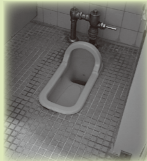
和式のままの老朽化したトイレ
