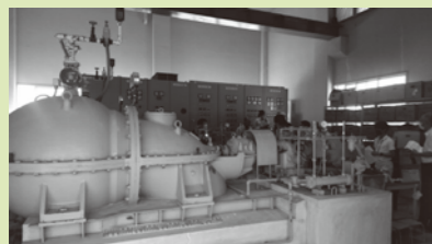
【西岡沖排水ポンプ】 37kwの能力のポンプが2基あり、排水量は1基毎分60m 3 です。
